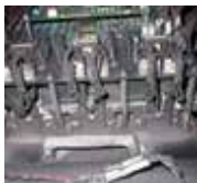
传统UPS内部积灰状态
